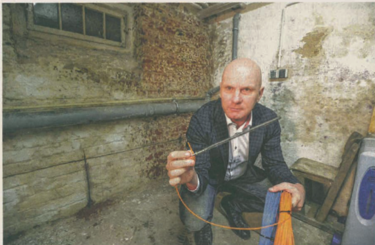
Frank Lindner, Geschäftsführer von Drymat, zeigt das patentierte System zur Mauertrockenlegung. Die Anode wird ins Mauerwerk eingebracht; hier im Keller eines Wohnhauses in Chemnitz. FOTO: YON SÖLL
